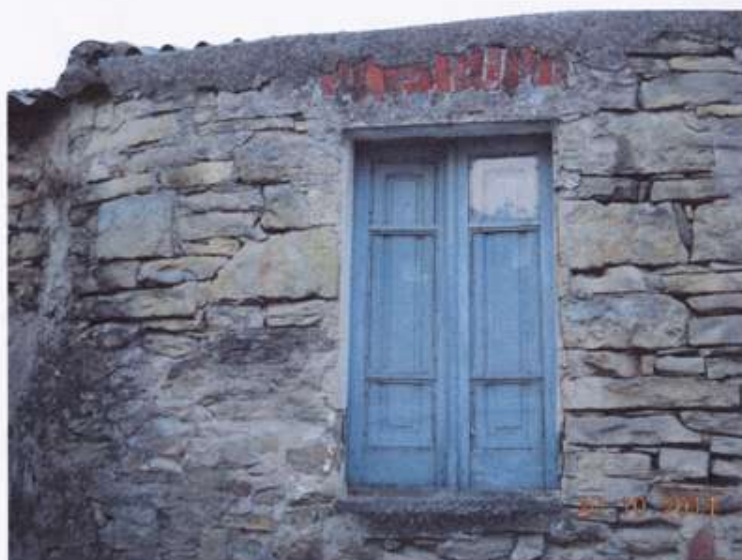
PARTICOLARE FINESTRA DA SOSTITUIRE
