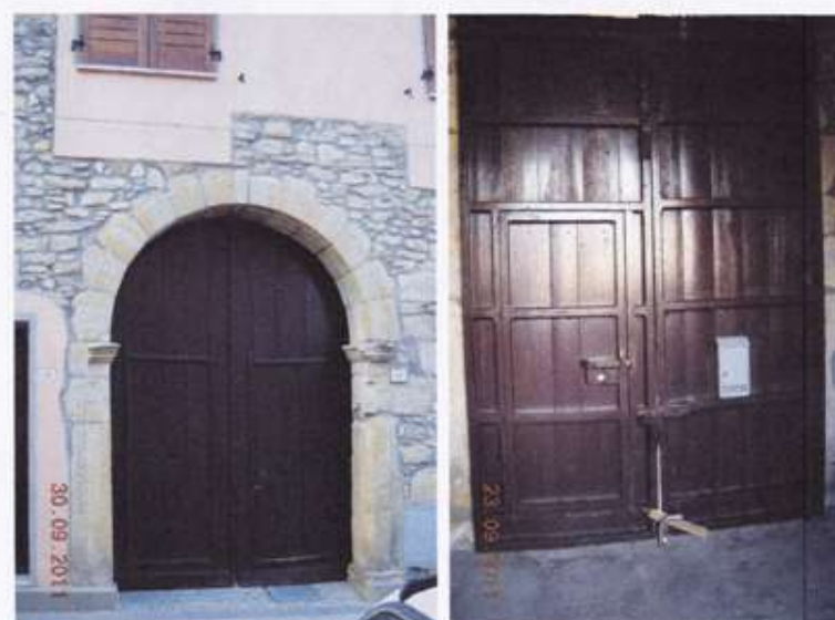
PORTONE DA SOSTITUIRE VIA ROMA (esterno - interno)
